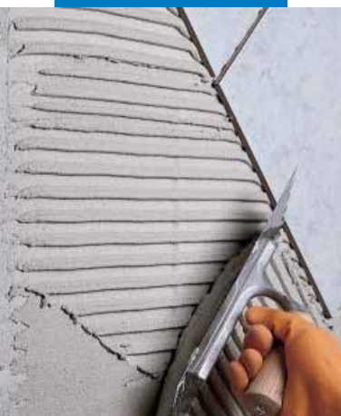
Colocación de baldosas de monococión sobre paredes de bloques de hormigón celular expandido
